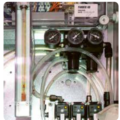
Blick in das Innenleben unserer Rauchanlage.
